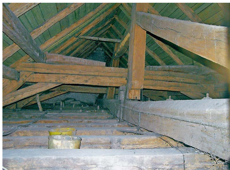
Laut Architekt Stefan Klein sieht der Dachstuhl ziemlich verheerend aus.
