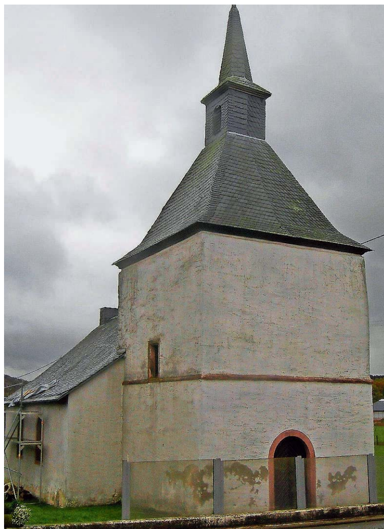
An der denkmalgeschützten Katharinenkapelle in Selbach stehen Restaurierungsarbeiten an. FOTOS: FRANK FABER
